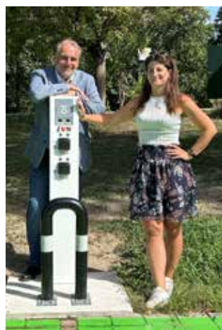
Stromtankstelle beim Veranstaltungszentrum
